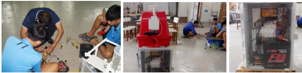
ภาพที่ 3.4 การติดตั้งระบบฉีดพ่นน้ำแอลกอฮอล์ฆ่าเชื้อ
