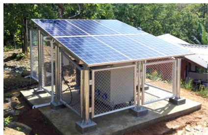
Solar cell 1.5kWp สำหรับโรงเรียนขนาดเล็ก
