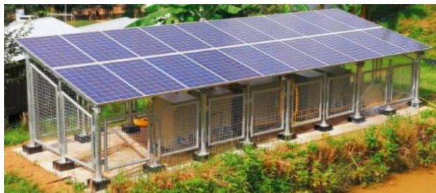
Solar cell 5kWp สำหรับโรงเรียนขนาดใหญ่
